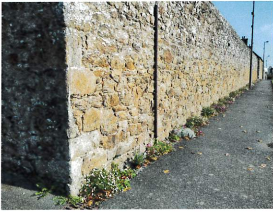
↳ Le pied de mur Rue Guy Homery
